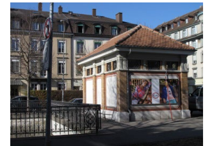
Nicht (mehr) bewilligungsfähige Plakatierung an Fassade Baudenkmal
