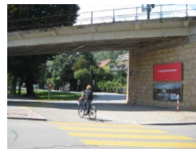
Ungeeigneter Standort an markantem, sorgfältig materialisiertem Viadukt (historisch-bautechnisch bedeutsam / ortsbildprägend).
